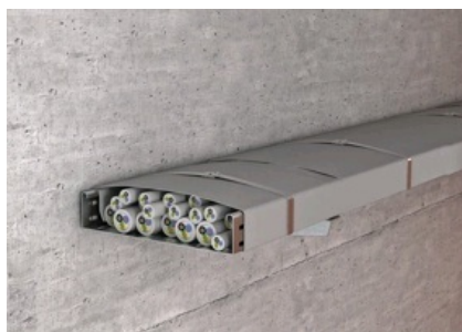
Slika 18. Bandažirana kabelska trasa, pričvrščena na zid
