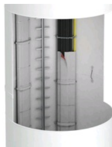
Slika 23: Bandažirana kabelska trasa v stebri vetrne elektrarne
