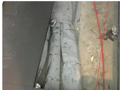
Slika 31: Bandažirana instalacija u podignutom podu.
