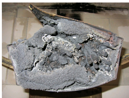
Slika 10: Presek Pyroline Rapid kanala po požaru v kanalu
