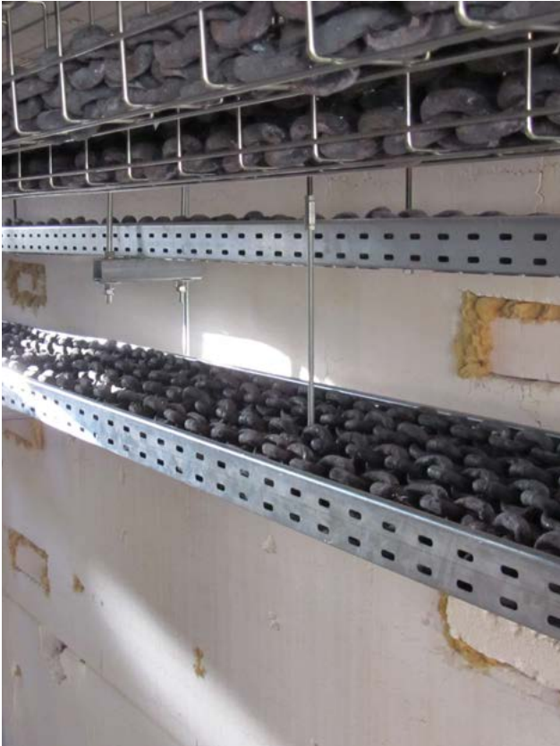
Kabelrinne mit hoher mechanischer Last vor...
